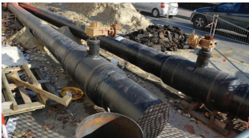
Il teleriscaldamento, servizio realizzato dalle società municipalizzate / Foto Express
